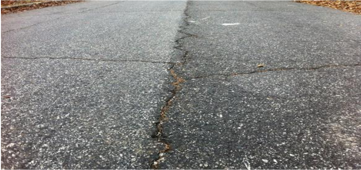
Longitudinal (Linear) Cracking
