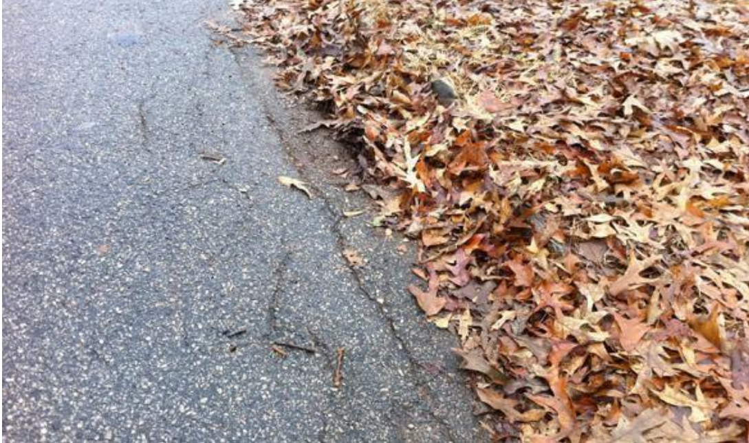
Fig. Edge Cracks
