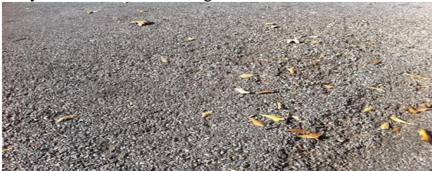
Fig. Raveling (very porous asphalt)
