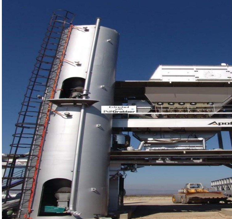
Fig. Mineral filler unit
